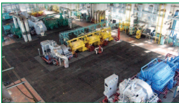
Рис. 1. Машинный зал установки по производству аммиака
