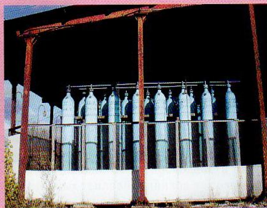
Рис. 1. Секции реципиентов на ОАО «Чусовской металлургический завод»
