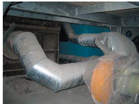
Рис. 4. Вентиляторы подачи воздуха к магнитным подшипникам компрессора и турбины
