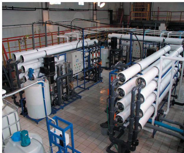
Рис. 5. Зворотноосмотична установка, пущена у 2003 р. на фірмі «Сандора»
