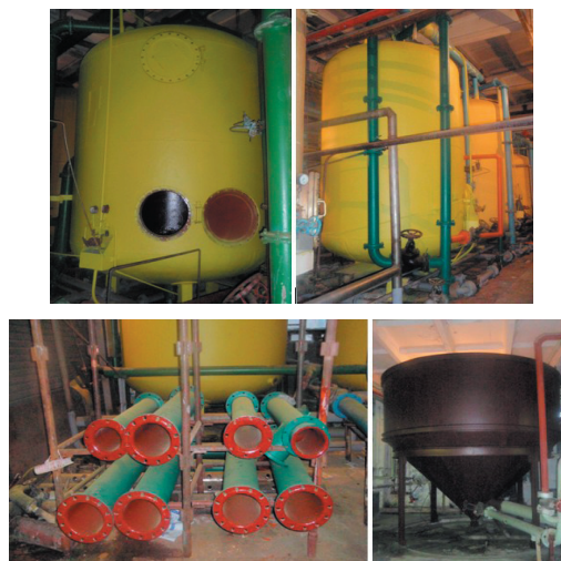
Рис. 2. Внешний вид антикоррозионной защиты на внутренних и наружных поверхностях емкостного оборудования ХВО и обвязывающих трубопроводов
