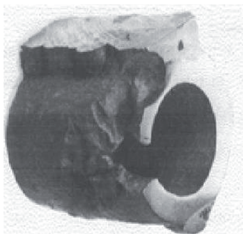
Рис. 1. Разрушившееся сварное соединение паропровода. Сталь 12X1MФ. \times 10 . Длительность эксплуатации 170000 ч, [3]
