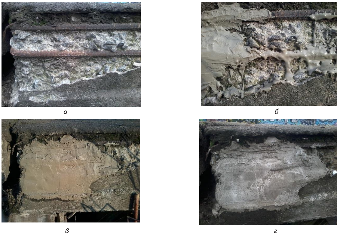
Рис. 7. Восстановление поврежденной участка плиты на платформе “Киевская Русановка” разработанной стекло- и шлак содержащей портландцементной композицией: а – поврежденный участок; б – защита арматуры; в – выравнивание повреждённого участка по плоскости плиты; г – внешний вид защитной композиции после 7 суток твердения
