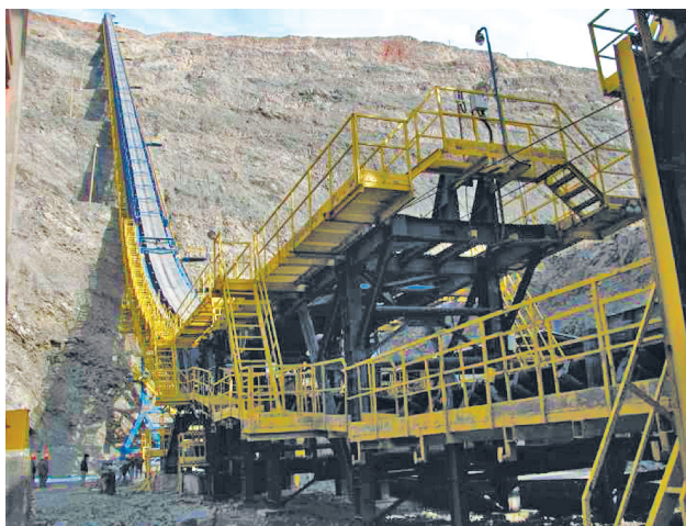
Рис. 2. Крутонаклонный конвейер комплекса ЦПТ-руда
