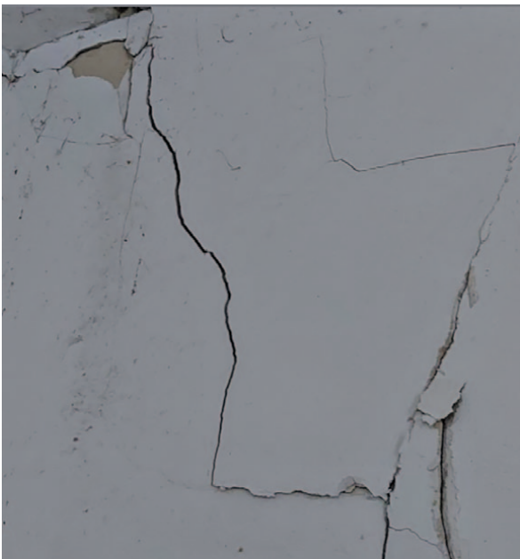
Рис. 5. Значні тріщини у внутрішній частині технічного двоповерхового будинку на вул. Геологічній.
