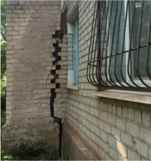
Рис. 4. Значна зовнішня тріщина на стіні житлового будинку по вул. Геологічній, м. Кривий Ріг, що знаходиться у зоні спуску до непрацюючого кар'єру ім. Калініна.
