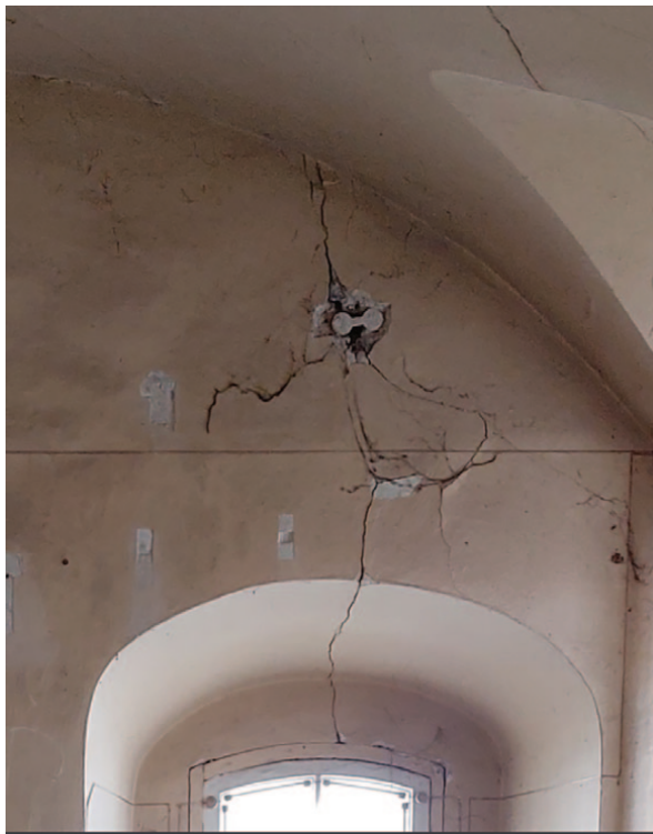
Рис. 2. Тріщини на верхній частині стіни корпусу № 4, який розташований зліва від Великої лаврської дзвіниці.
