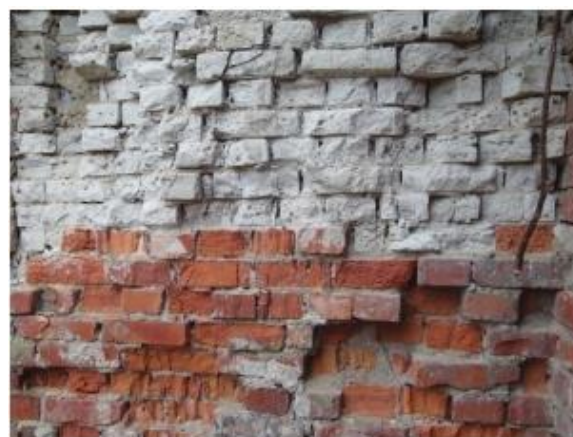
Рис. 3. Фрагмент пошкодженої стіни будівлі
