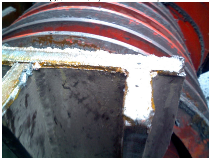
Рис. 3 – Зона разрушения стойки
