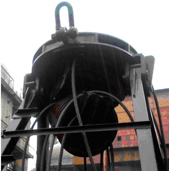
Рис. 2 – Разрушение стойки верхнего блока полиспаста механизма замыкания челюстей грейфера
