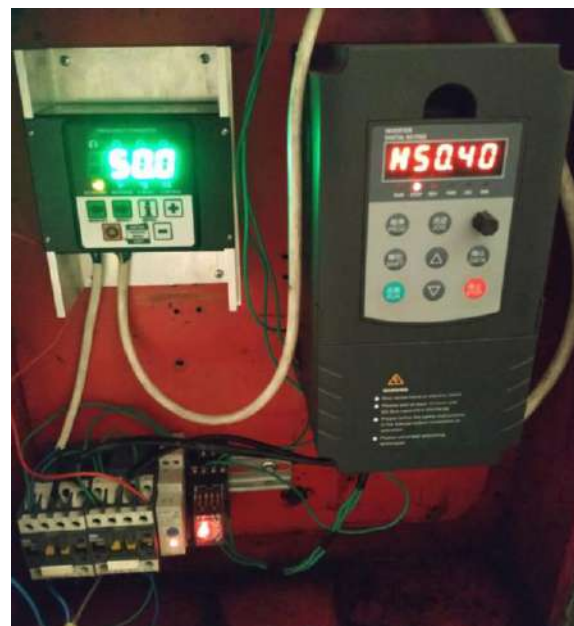
Рис. 4 – Фото системи електроприводу токарного верстату 1Е61М з перетворювачем частоти
